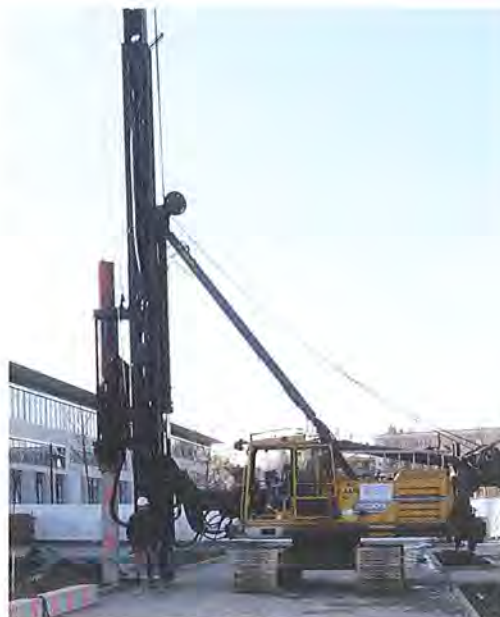
Kombinierte Pfahl-Platten-Gründung (KPP) mit Fertigteilrammpfählen für den Neubau eines sechsgeschossigen Verwaltungsgebäudes in Kempten (CENTRUM PFÄHLE)
